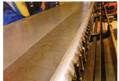
Mekanisk sikringsanlæg, som vi også kender det fra de "rigtige" jernbaner. Rolf Brems
