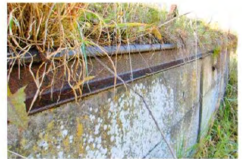
Rampen på Kauslunde trinbræt er armeret med gamle skinner 23. oktober 2008.
