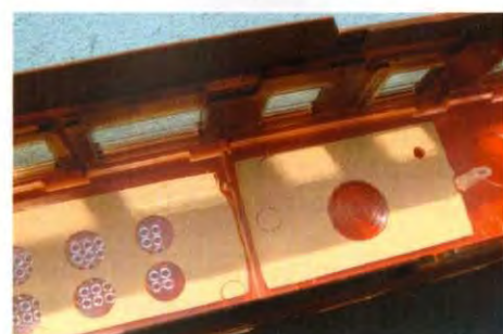
Indbygget lysfordeler i taget - men ingen belysning monteret.
