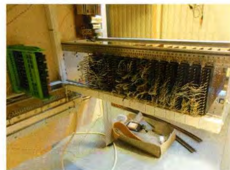
De elektriske installationer under anlægget viser, at Bernd var grundig og struktureret, der blev ikke gået på kompromis.
